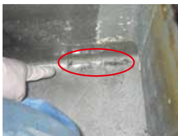
角の部分のクラック
