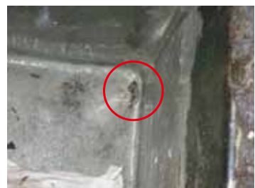
角の部分の破損・欠落
