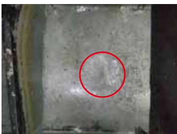
底部のひび割れ・凹み
