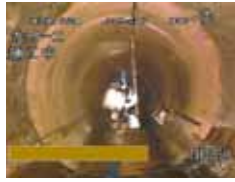
カッターではがし中 浸入水Aランクが出てきた
